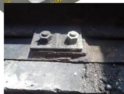
Lasverbindingen van railklemmen beginnen corrosie te vertonen.
