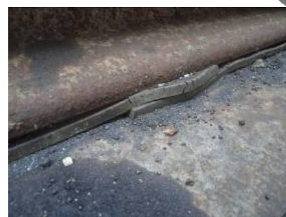
De railpad is niet correct geïnstalleerd.
